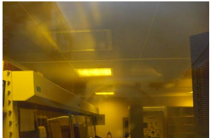
Zona Clasificada. Techos Transitables con filtros absolutos y luminarias estancas.
