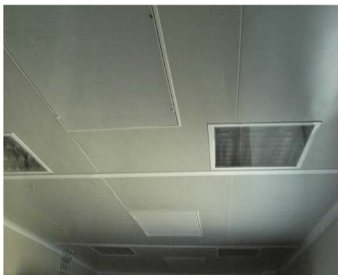
Zona clasificación. Techos transitables con filtros absolutos y luminarias estancas.
